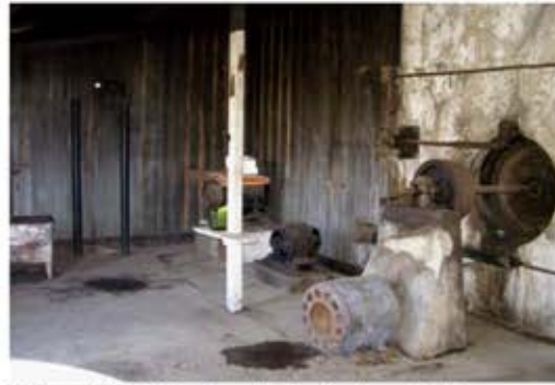
Fotografía 2: Interior sala de máquinas Turbina
